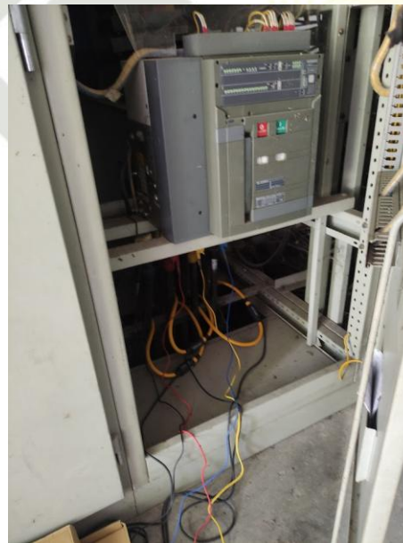
Gambar 3.4 Panel LVMDP (Sumber: Foto Langsung)
