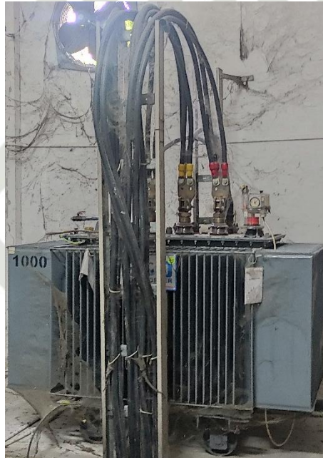
Gambar 3.2 Transformator 1000 kVA UIN Sultan Syarif Kasim Riau (Sumber: Foto Langsung)
