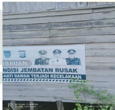
Gambar : Peringatan Pemerintah Terkait Kerusakan Jembatan Kecamatan Concong
