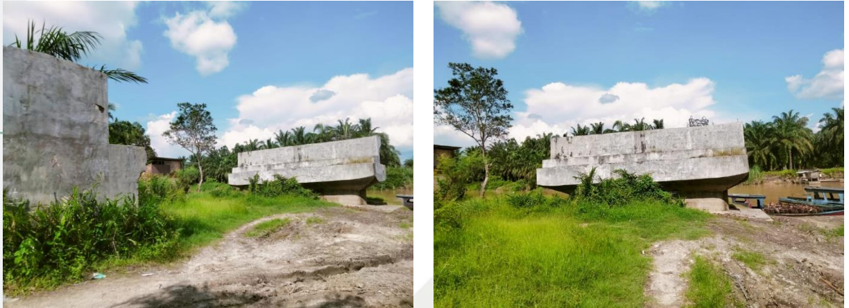
Gambar 1.2 Bangunan jembatan yang mangkrak
