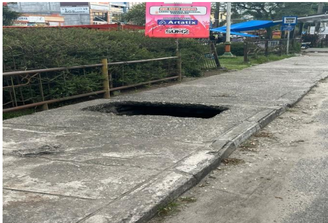
Gambar 1.2 Trotoar Yang Rusak
