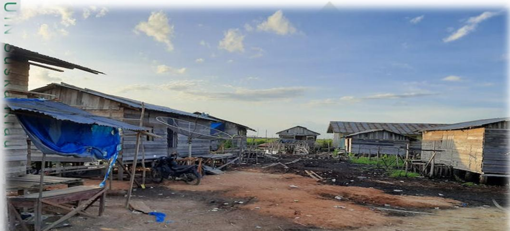
Sumber Data : Dokumentasi/arsip Desa Petani, 2022, Peneliti : Rafi Pramadeja, Lokasi : Kampung Sakai Desa Petani; Pukul 13:00 WIB. Ket: Kondisi rumah masyarakat Sakai
