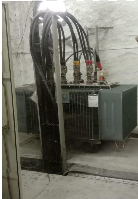
Gambar 3.1 Transformator 1000 KVA UIN SUSKA RIAU
