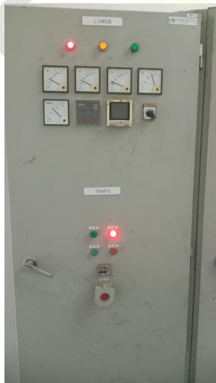
Gambar 3.4 Panel LVMDP Transformator UIN SUSKA RIAU (Sumber : Foto Langsung)
