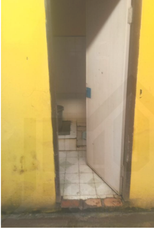
WC di SMPN 2 Kuantan Hilir yang rusak
