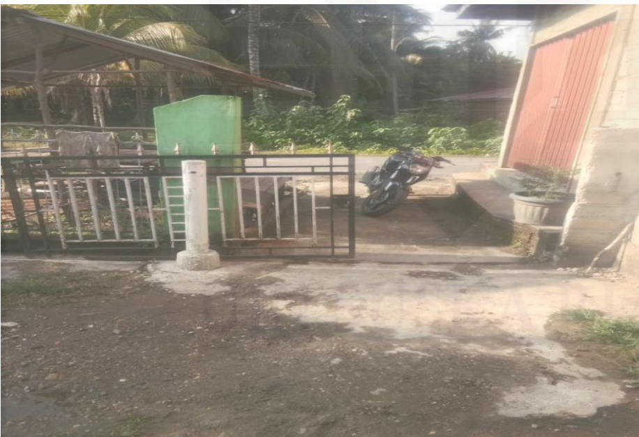
Pagar yang rusak
