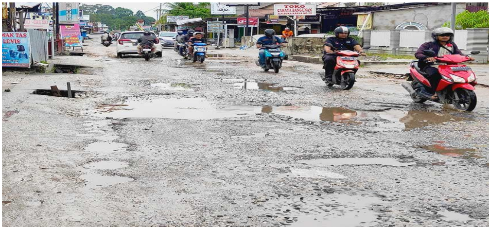
Gambar 1.1 Kondisi jalan rusak di jalan Suka Karya Kota Pekanbaru.
