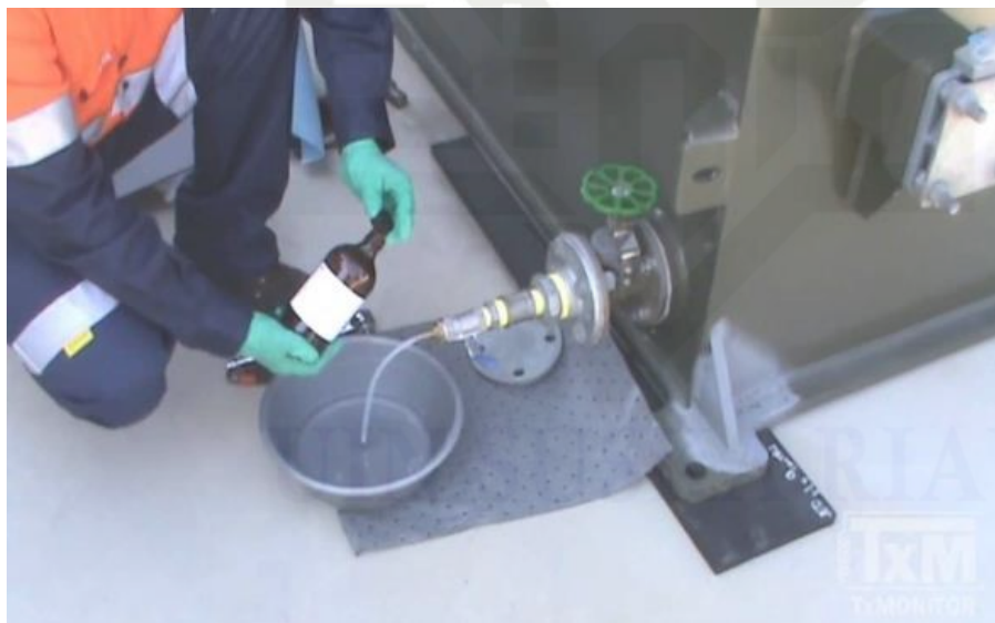
Gambar 2. 5 Pengambilan Sampel Minyak pada Hermetic Type Transformer [10]
