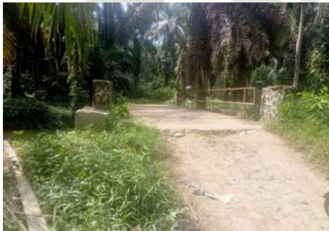
Gambar salah satu pembangunan Jembatan Desa Pulo Liman yang menghubungkan ke Lahan Perkebunan masyarakat Desa
