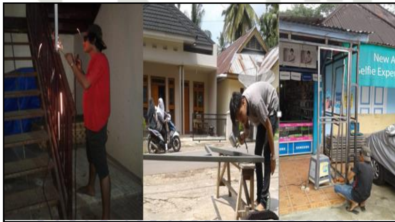
Gambar 1.1 Pekerja Tidak Menggunakan Alat Pelindung Diri (Sumber: CV. Jazila Teknik, 2020)
