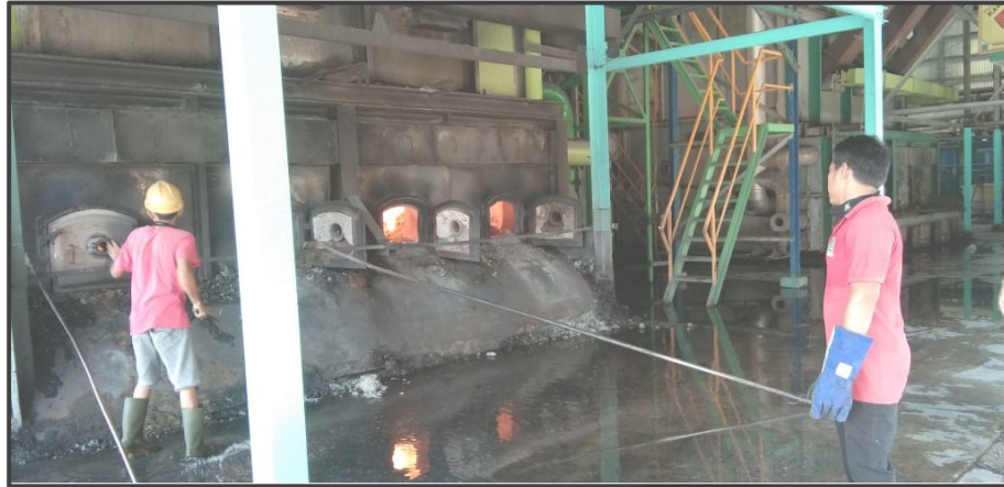
Gambar 4.11 Stasiun Boiler Konversi Energi
