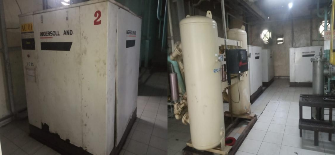
Gambar 2.7 Kompresor Udara Unit SSR PT.Wilmar Nabati Indonesia [2].
