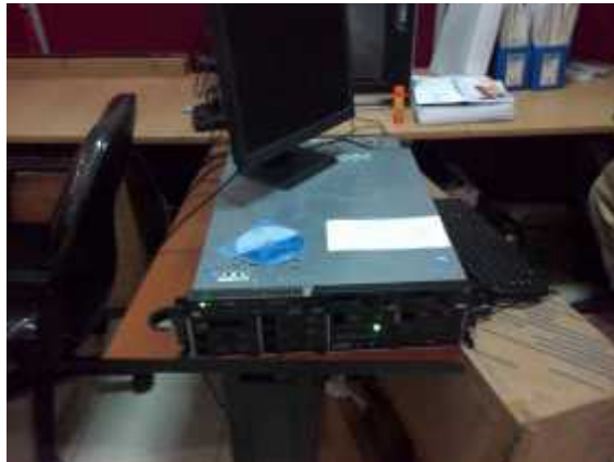
Gambar 4.4 Salah Satu Server di PT. Bank Riau Kepri Saat Ini
