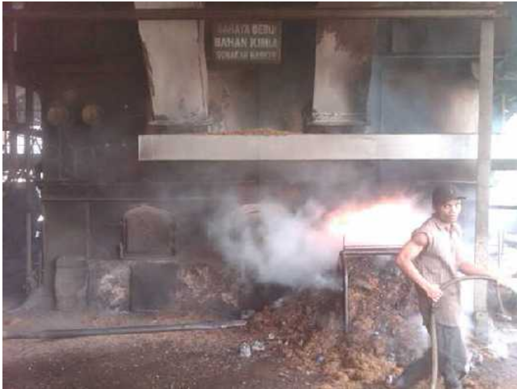
Gambar 4.2 Mesin Boiler PKS Kebun Terantam
