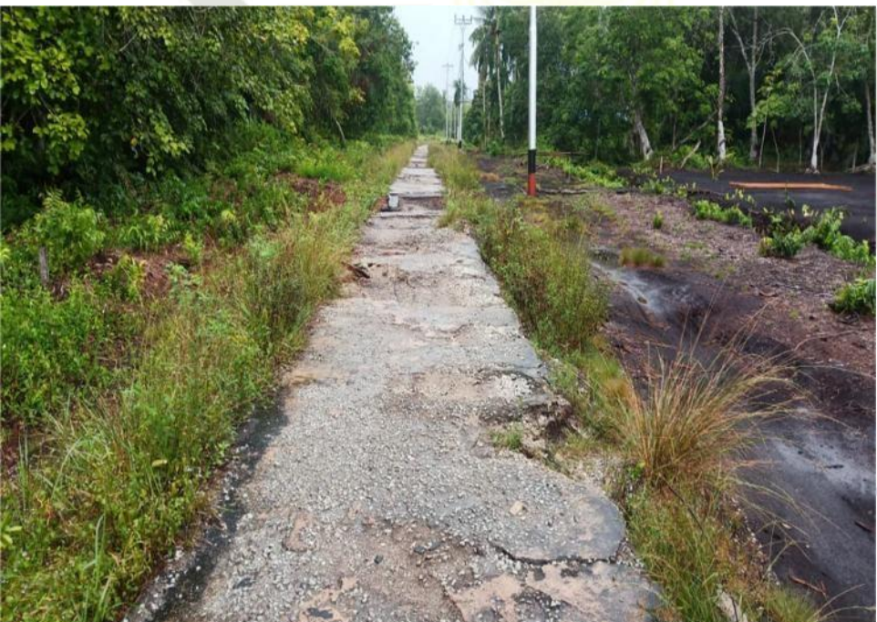
Kondisi Jalan Api-api
