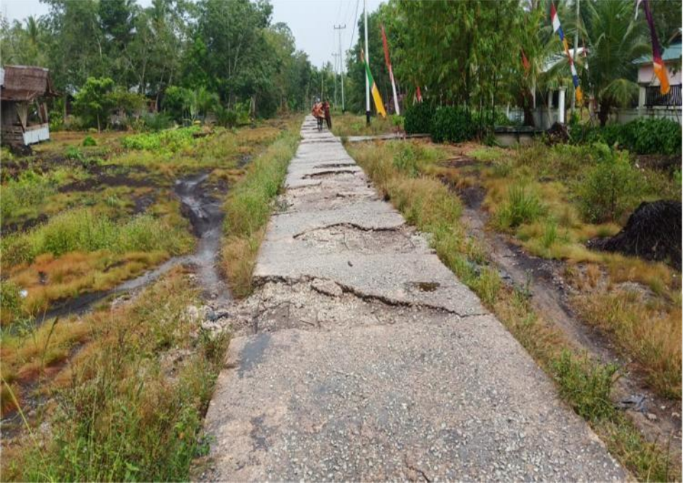
Kondisi Jalan Parit Jawa yang berlubang
