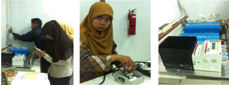
Gambar 94. Persiapan sistem kontrol: BCR, inverter, dan peralatan proteksi
