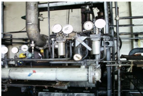
Gambar 2.6. Kompresor udara PT. Pertamina (Persero) RU II Dumai.
