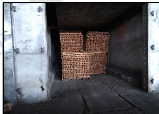
Departemen Kamar Uap (Mesin Boiler )
