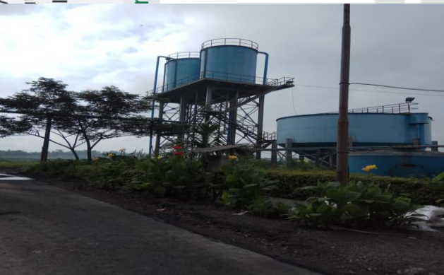
Tanki pengolahan air
