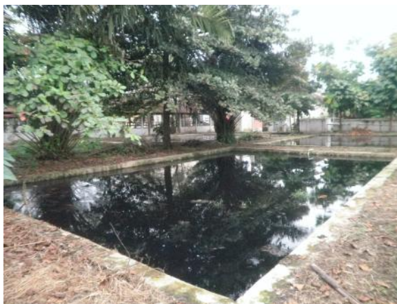
Gambar 6. Instalasi Pengolahan Air Limbah (IPAL) RPH Kota Pekanbaru
