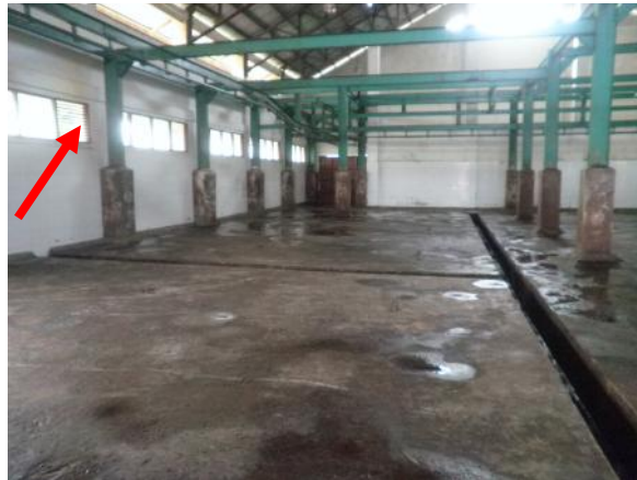
Gambar 3. Ventilasi Udara pada Bangunan RPH Kota Pekanbaru
