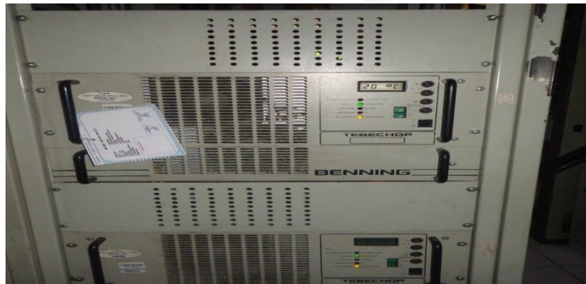
Gambar 2.5 Rectifier Rectifier Benning E110-240G48 BWRU-PDT ( Sumber : PT.Telkom Area Network Daratan Pekanbaru )
