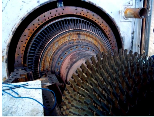
Gambar 2.14 Kompresor pada PLTG PT. Riau Power Pekanbaru
