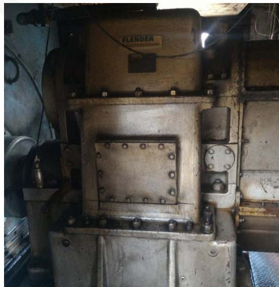
Gambar 2.19 Load Gear PLTG PT. Riau Power
