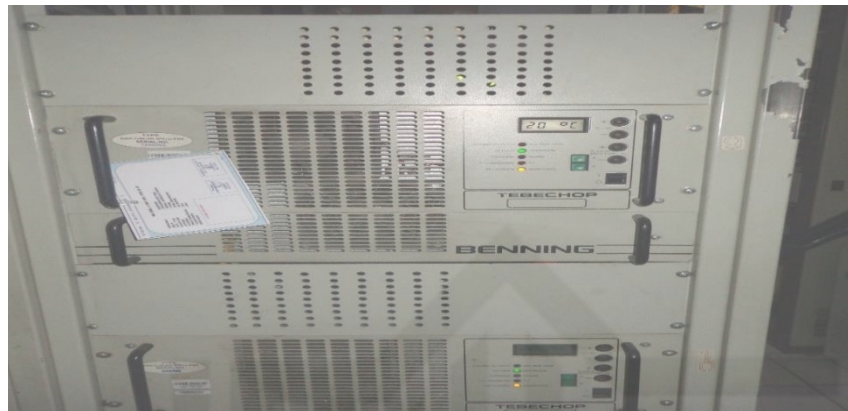
Gambar 2.5 Rectifier Benning E110-240G48 BWRU-PDT
