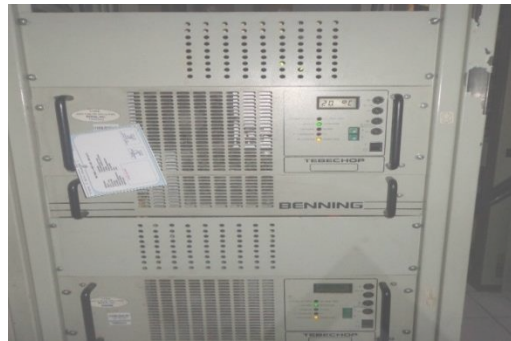
Gambar 2.6 Rectifier Rectifier Benning E110-240G48 BWRU-PDT
